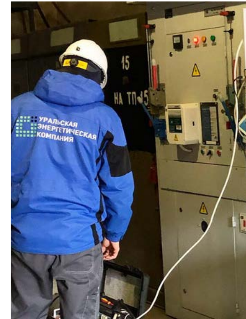
Монтажные и обслуживающие организации производственного оборудования и сетей электроснабжения
