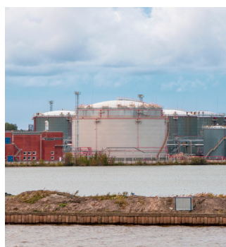
Газораспределительная станция Усть-Луга, Ленинградская область
