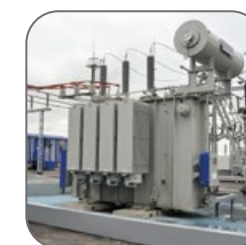
Объекты энергетической отрасли
