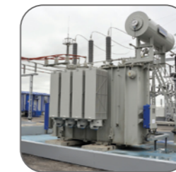
Объекты энергетической отрасли
