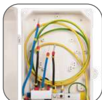
Соединения силовой цепи выполнены медным проводником сечением 10 мм
