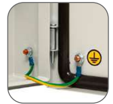
Обмедненные шпильки заземления. Закрепленный поводок заземления
