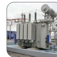
Объекты энергетической отрасли
